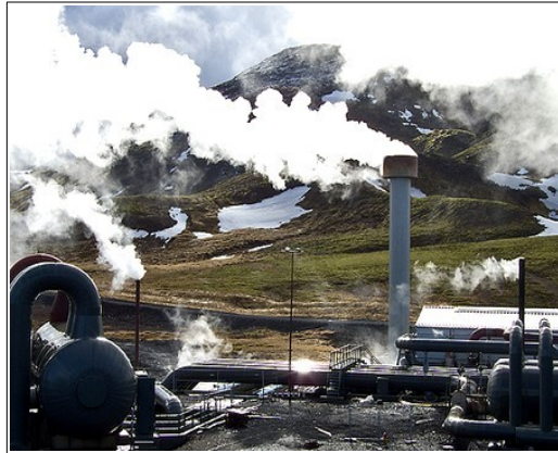
Centrale géothermique Islande
